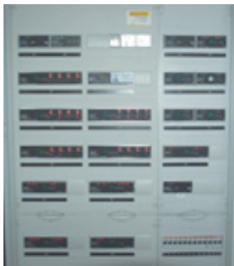
In der Steuerungszentrale laufen alle Befehle zusammen.
